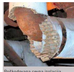
Poškodovana cevna izolacija
